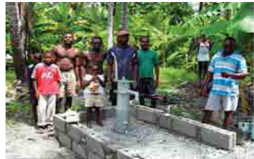
Poço em funcionamento
